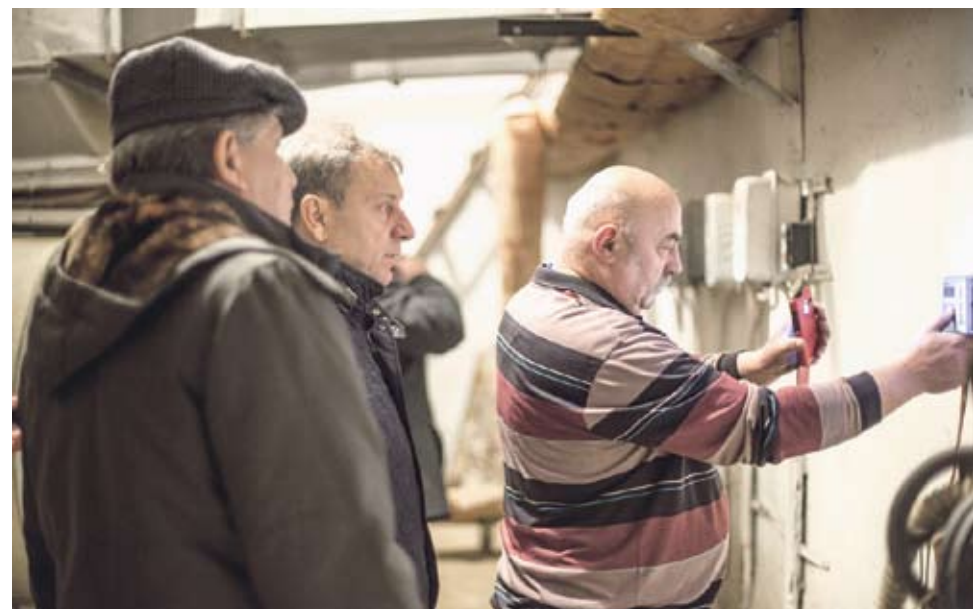
Проверка работы системы отопления в Бишкильской школе.
